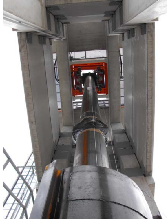
Figura 8. Verticalazione: piattaforma per controllo verticalizzazione.
